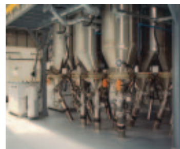
La nuova tecnologia CCM (Continuous Compound Mixing) integrata nell'impianto MIRS™ di Milano Bicocca.
